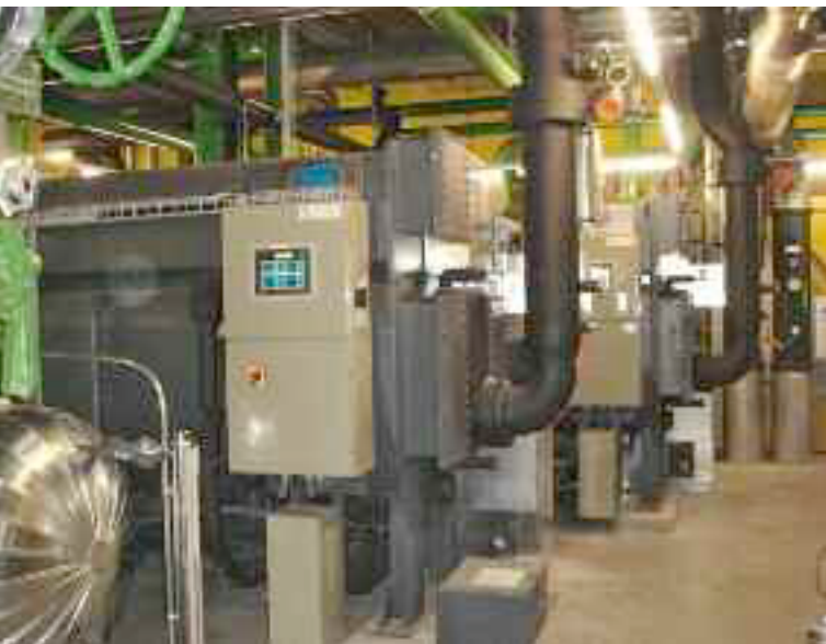
Absorptionskältemaschine in der Betriebszentrale Migros Aare Schönbühl
