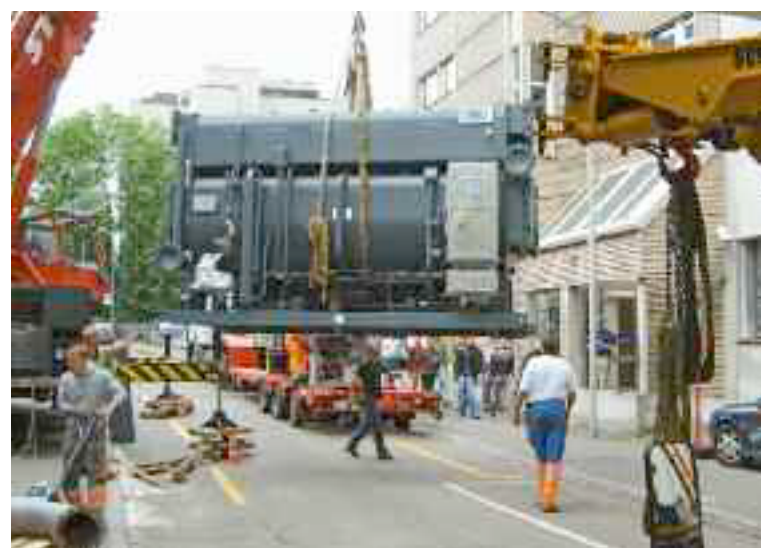
Doppeleffekt Absorptionskältemaschine mit einer Leistung von 2 MW für das Unispital in Zürich beim Transport in den Maschinenraum
