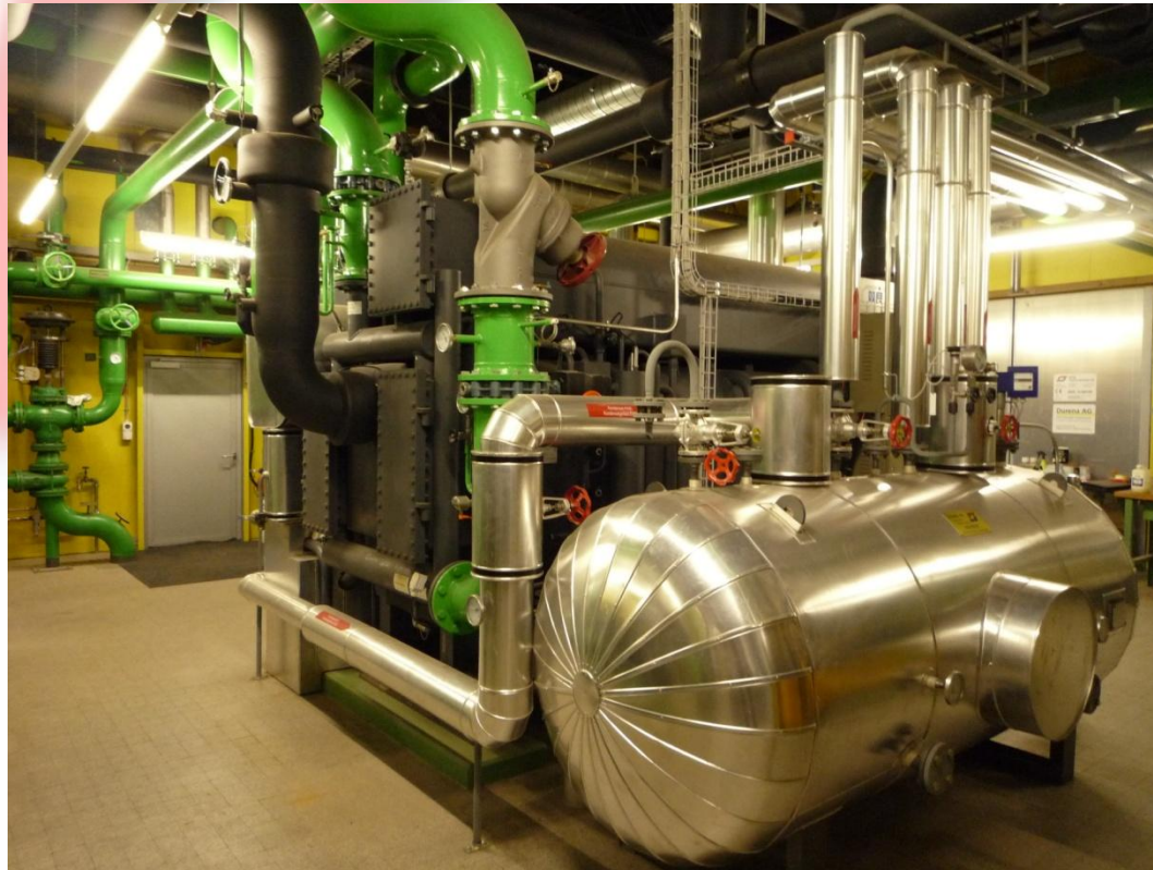
Absorptionskältemaschine mit Kondensatsammler
