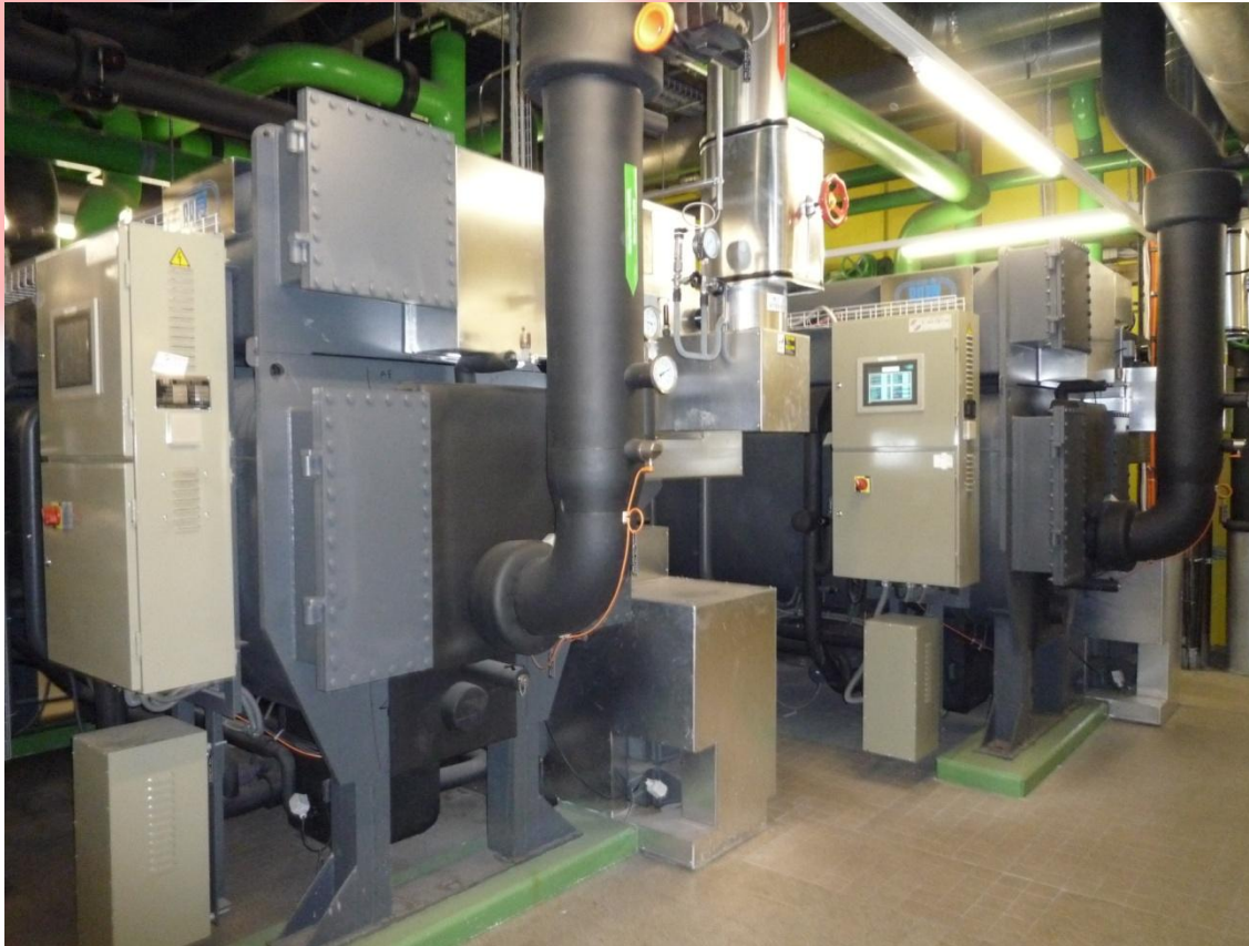
Maschinenraum, Ansicht der zwei Absorptionskältemaschinen Februar 2010
